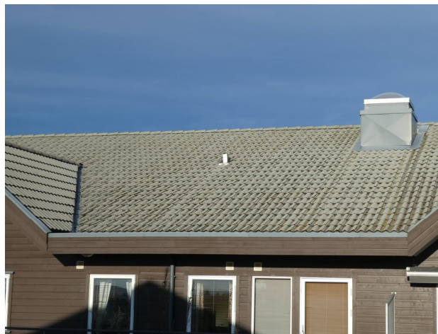
Taktekkingen har en del begroing.
