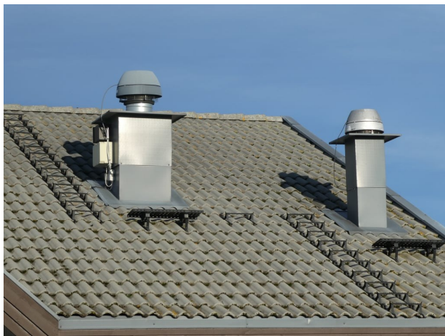
Taktekkingen har en del begroing.
