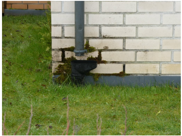
For korte nedløpsrør, skader fasaden.
