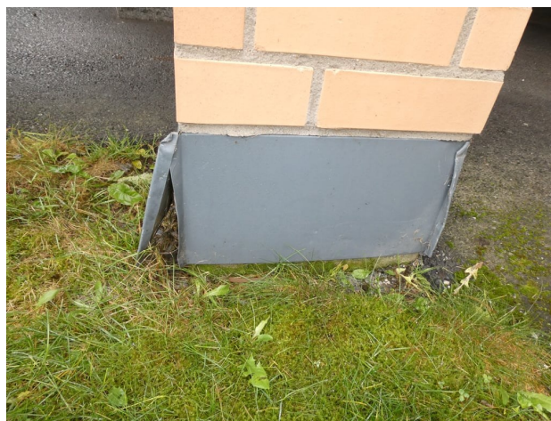
Skader i beslag rundt søyler.
