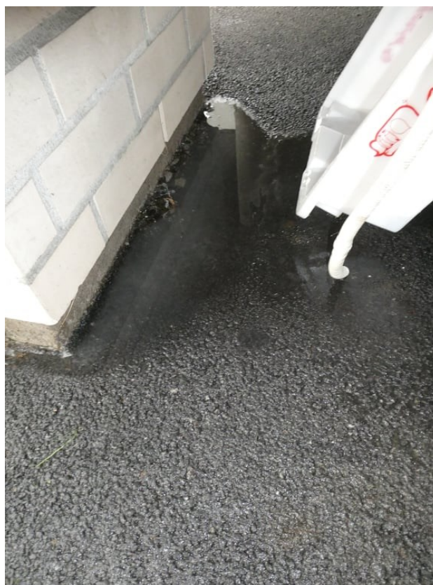
Vannansamling rundt betongsøyle.
