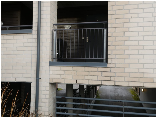
Tydelige skjevheter i konstruksjon.
