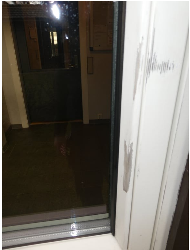
Slitasje på vindu.
