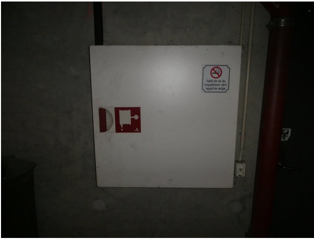
Slokkerutstyr i form av brannslanger på fellesområder.
