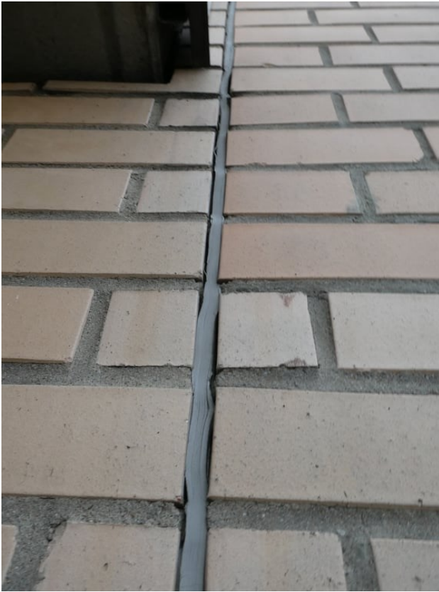
Dillitasjonsfuger må skiftes.
