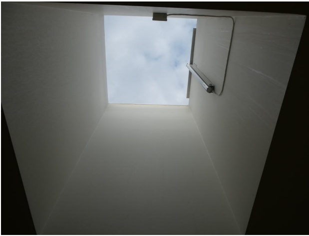
Røykluker i tak/trappegangene.
