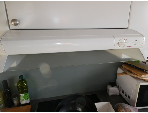
Kjøkkenventilator i befart bolig.
