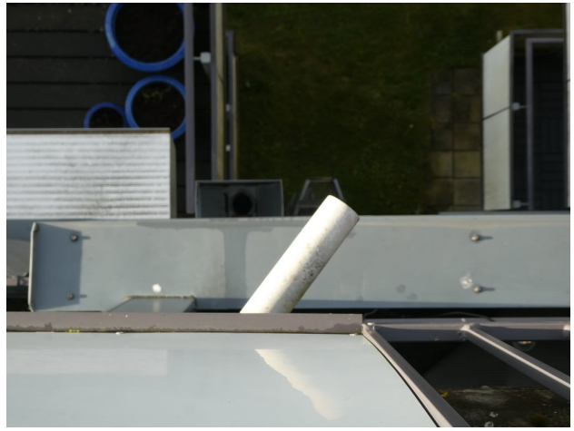
Nedløp som bommer på trakt under. Det er observert flere steder.
