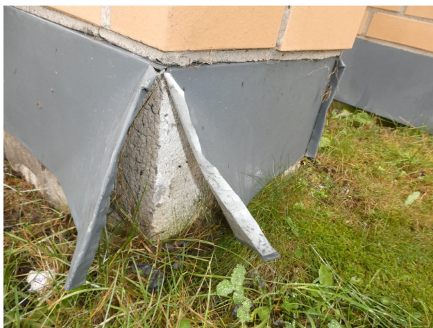
Skader i beslag rundt søyler.
