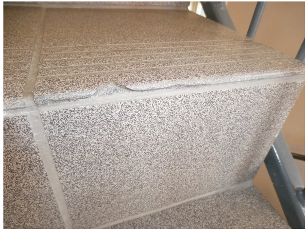
Skader på trappetrinn.
