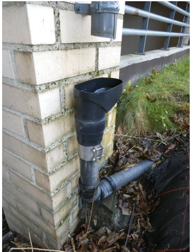
For korte nedløpsrør, skader fasaden.
