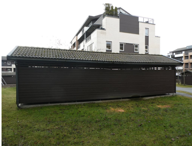
Store skjevheter og betongsåle har sunket.
