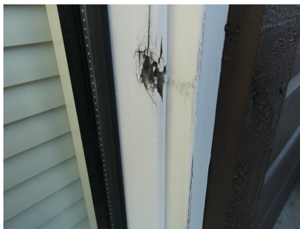
Skade på vindu.
