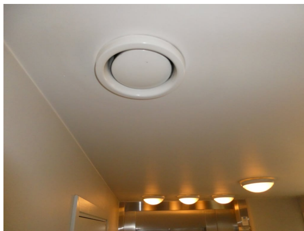
Ventilasjon fellesområde, avtrekk korridor.
