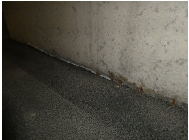
Skader i betong.
