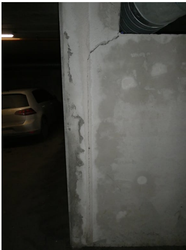
Mindre riss i vegg søyler.
