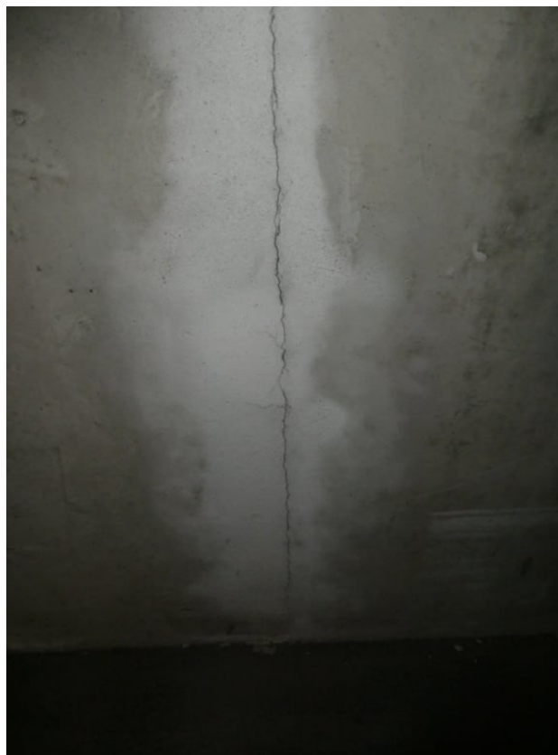
Mindre riss i betongvegger.
