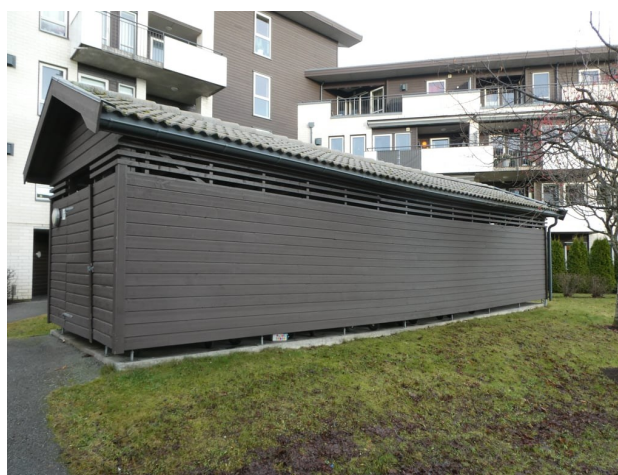
Store skjevheter og betongsåle har sunket.
