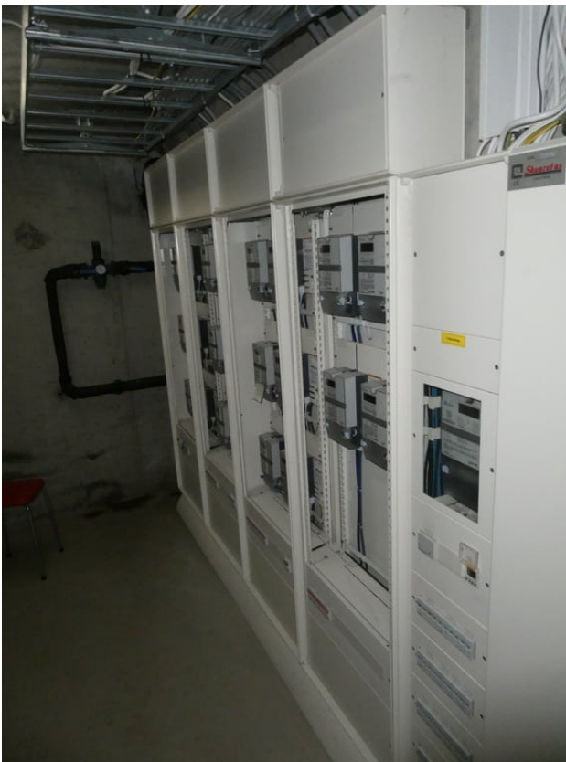
Hovedtavle i befart blokk.
