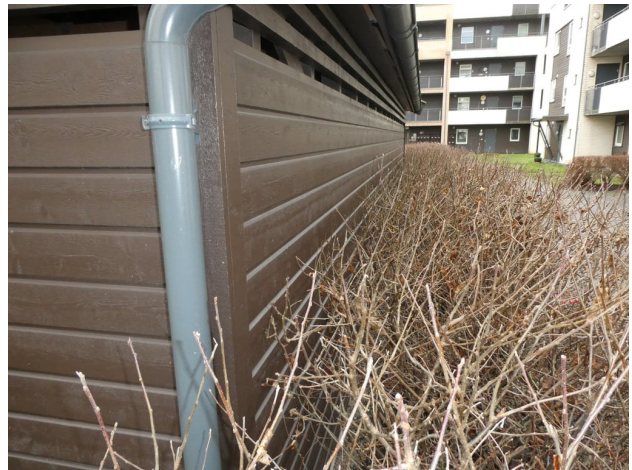
Hekk for nærme trekledning.
