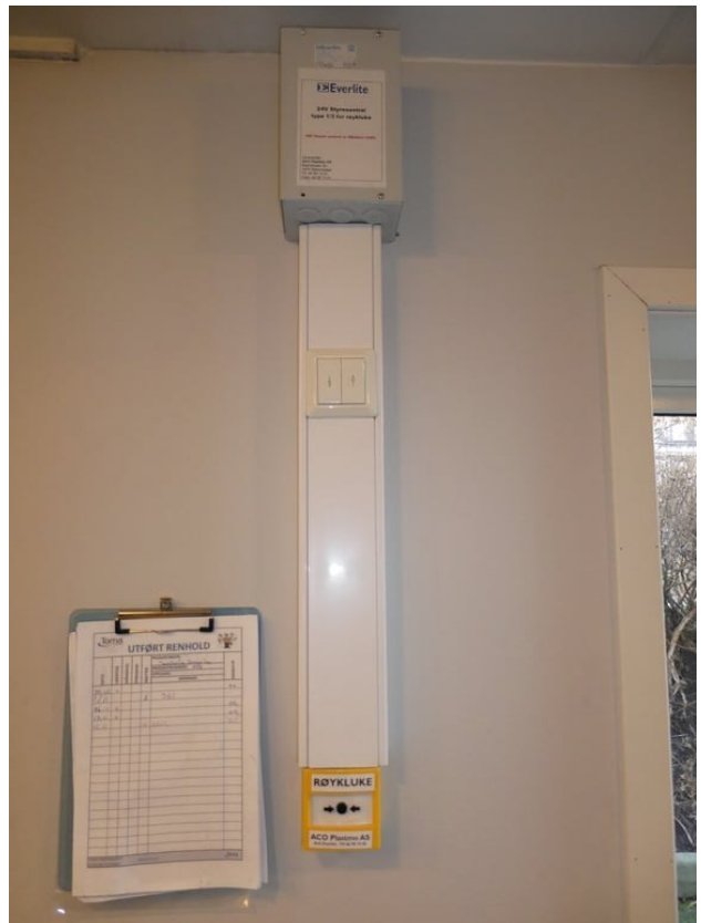
Styringspanel i 1.etg ved ytterdør.
