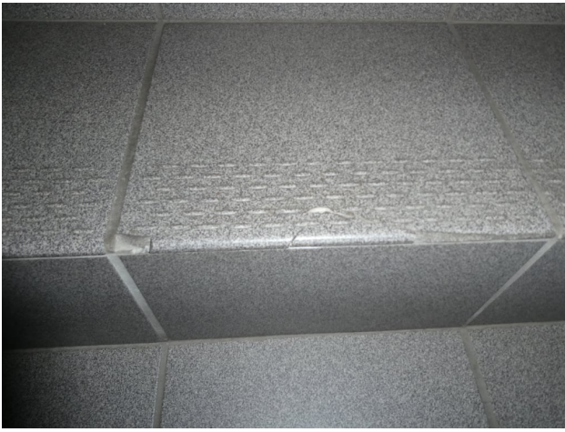
Skader på trappetrinn.
