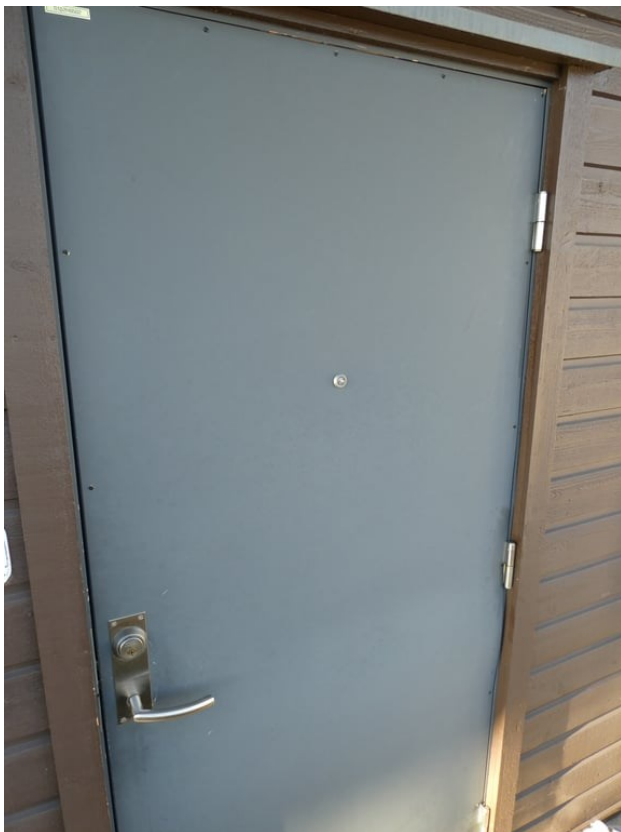
Inngangsdør hvor dørbildet er skrudd sammen med skruer.
