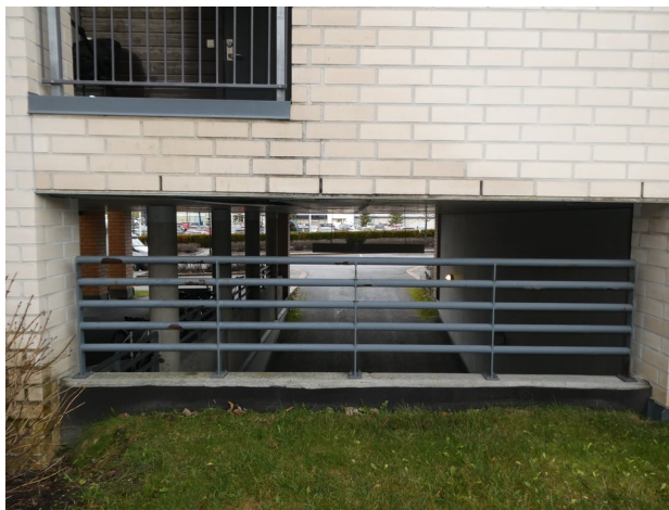
Bulning nedover midt på vegg. Riss i tegl.
