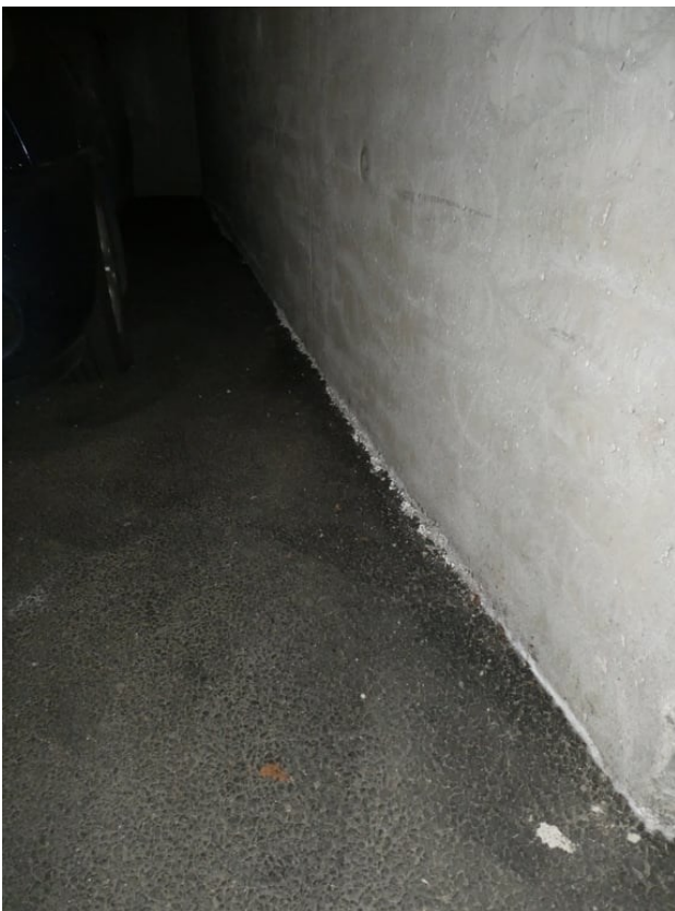
Noe saltutslag overganger gulv-vegg.
