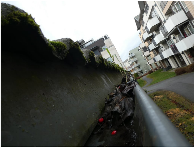
Mye skitt og mose i takrenner.
