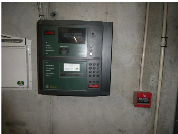
Brannsentral plassert i kjeller.
