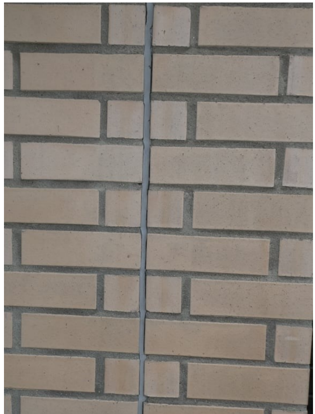
Dillitasjonsfuger må skiftes.
