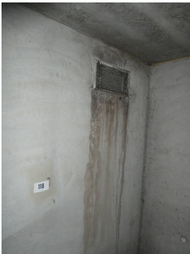
Ventilasjon fellesområde, tilluft i garasjer.
