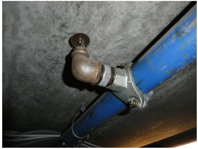
Hele bygget har sprinkelanlegg, fellesområder og boliger.
